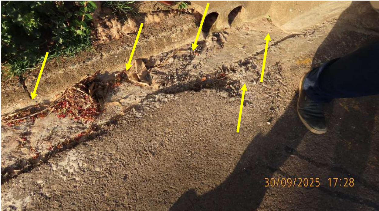
Foto 85 > Destaque para os resquícios de concreto na sarjeta.
