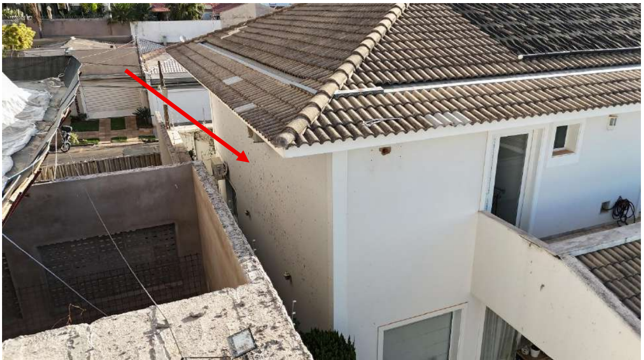
Foto 12 > Detalhe para parede que foi mais atingida por respingos de reboco.
