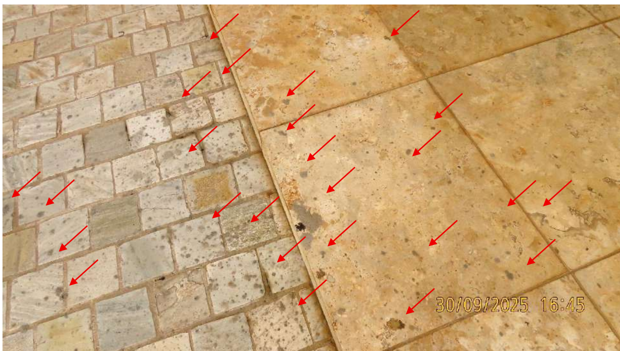
Foto 48 > Detalhe para os resquícios de massa da obra.
