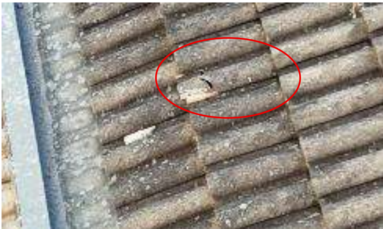
Foto 20 > Detalhe para telha danificada, além de respingos (argamassa) de forma generalizada.
