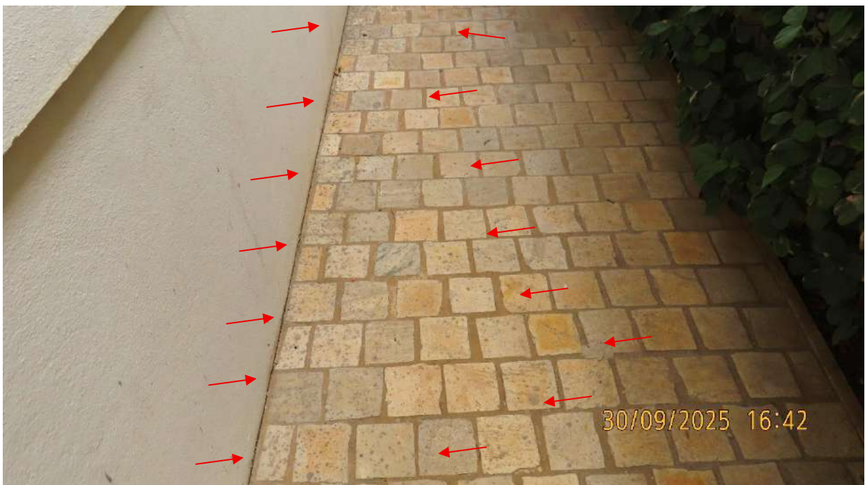
Foto 36 > Detalhe para os respingos de argamassa.
