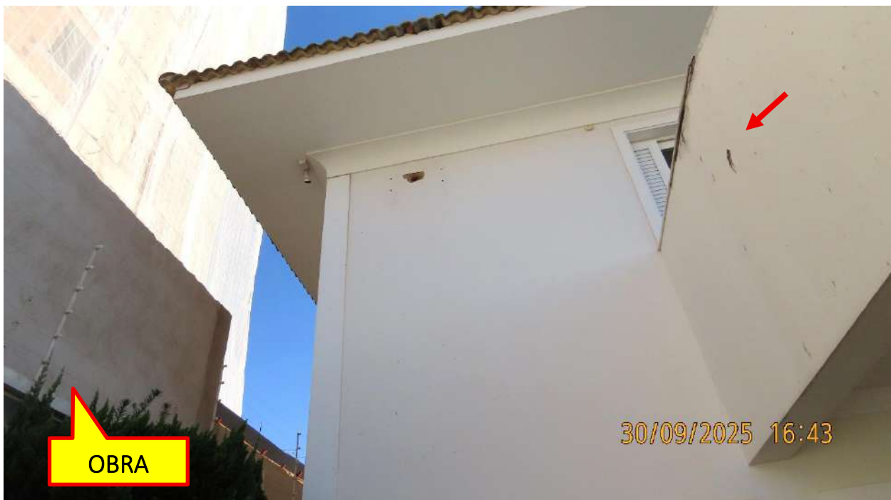
Foto 42 > Detalhe parcial do fundo do imóvel. A seta vermelha indica respingos de concreto.
