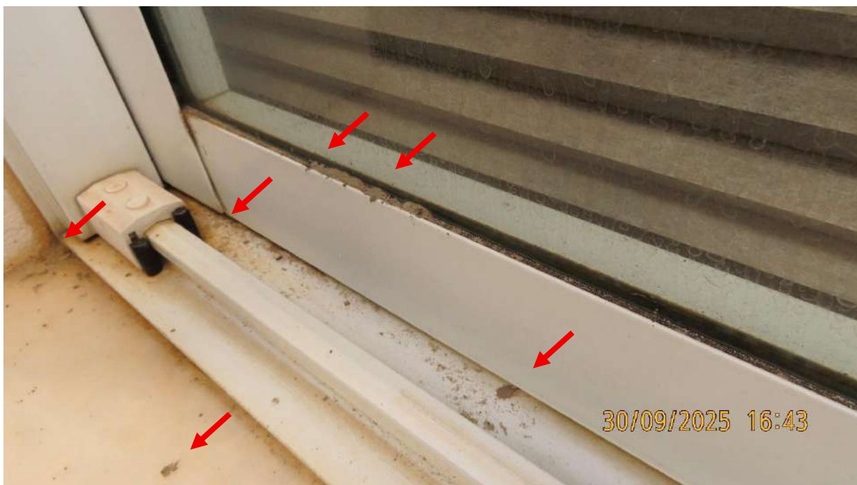
Foto 39 > Detalhe para os respingos de massa na esquadria de alumínio da janela.
