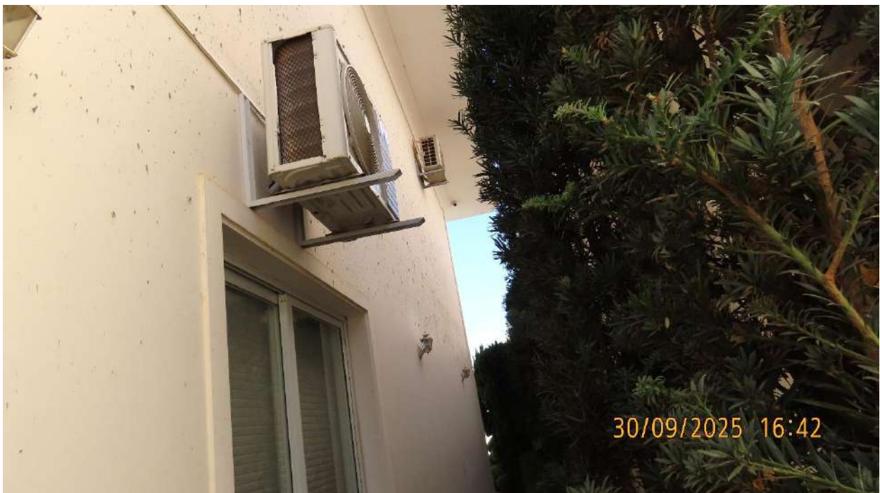
Foto 30 > Detalhe para parede, condensadora de ar-condicionado e esquadria com respingos de concreto.
