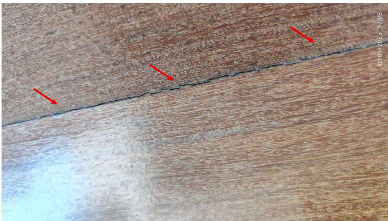
Foto 75 > Detalhe de foto aproximada da junta dos tacos de madeira.
