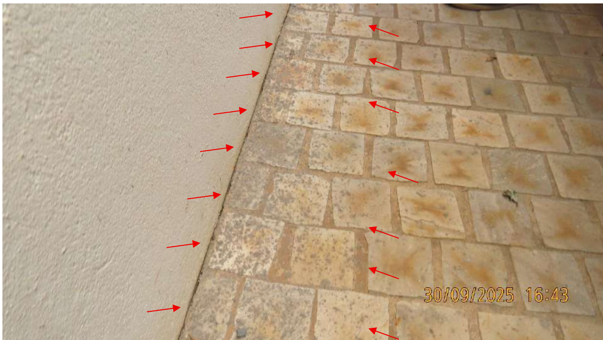
Foto 37 > Detalhe para os respingos de argamassa.
