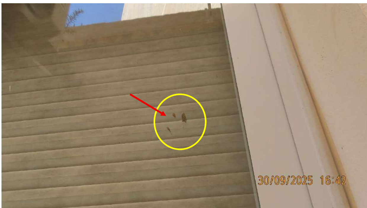
Foto 38 > Em destaque, resquícios de concreto no vidro.
