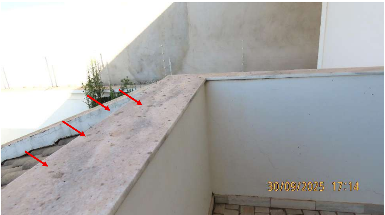
Foto 78 > Detalhe de revestimento de granito, afetado por respingos de argamassa, provenientes da obra vizinha.
