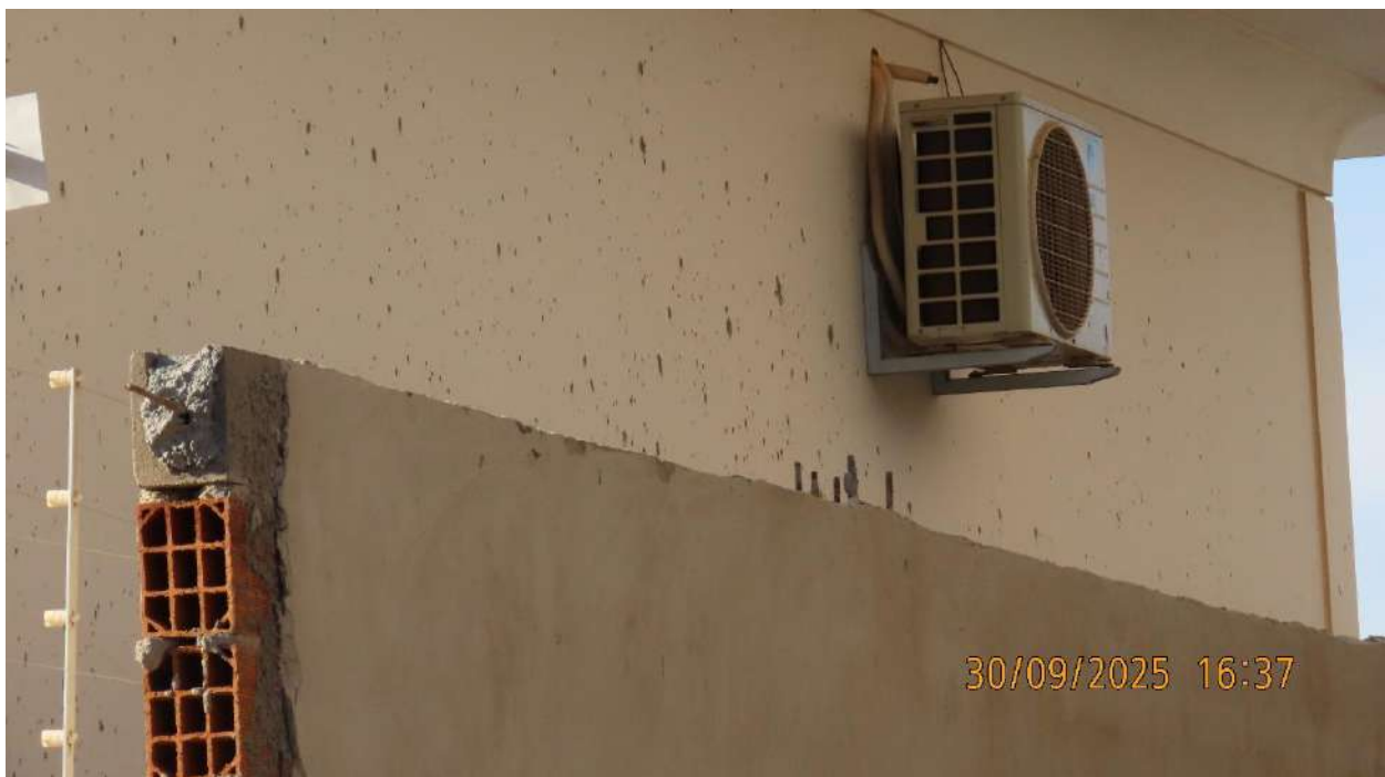
Foto 28 > Notar parede com muito respingo de massa.
