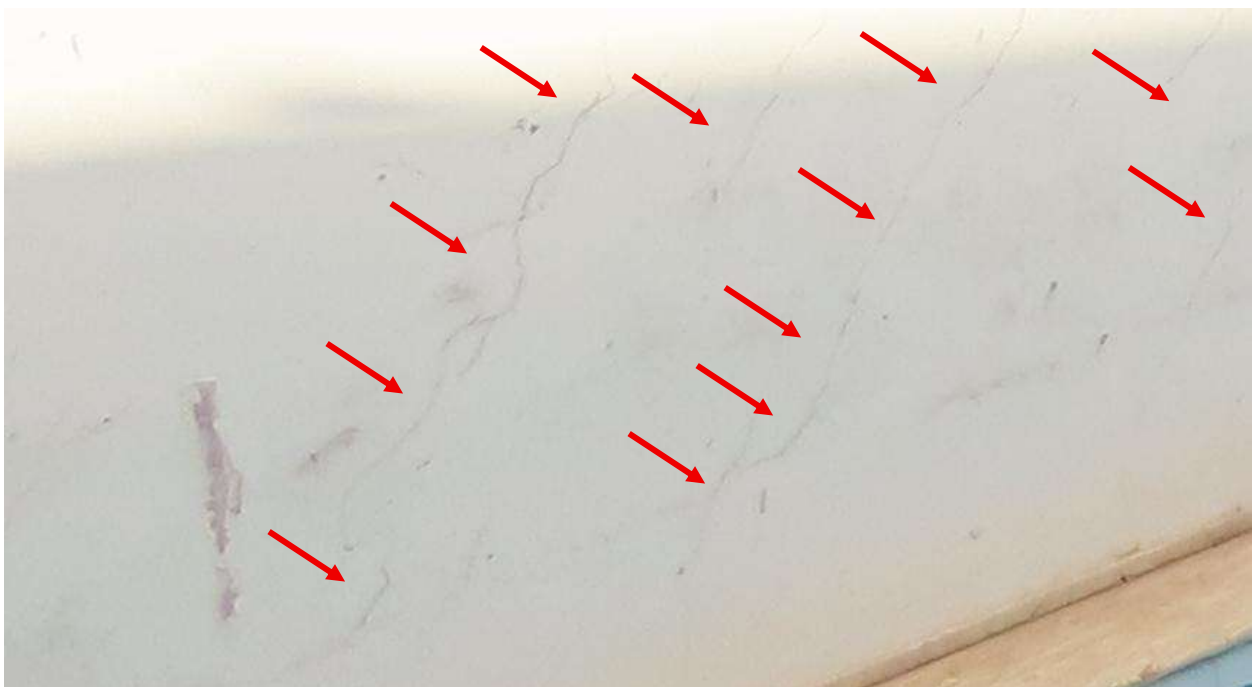
Foto 82 > Indícios de trincas por interferência da obra.
