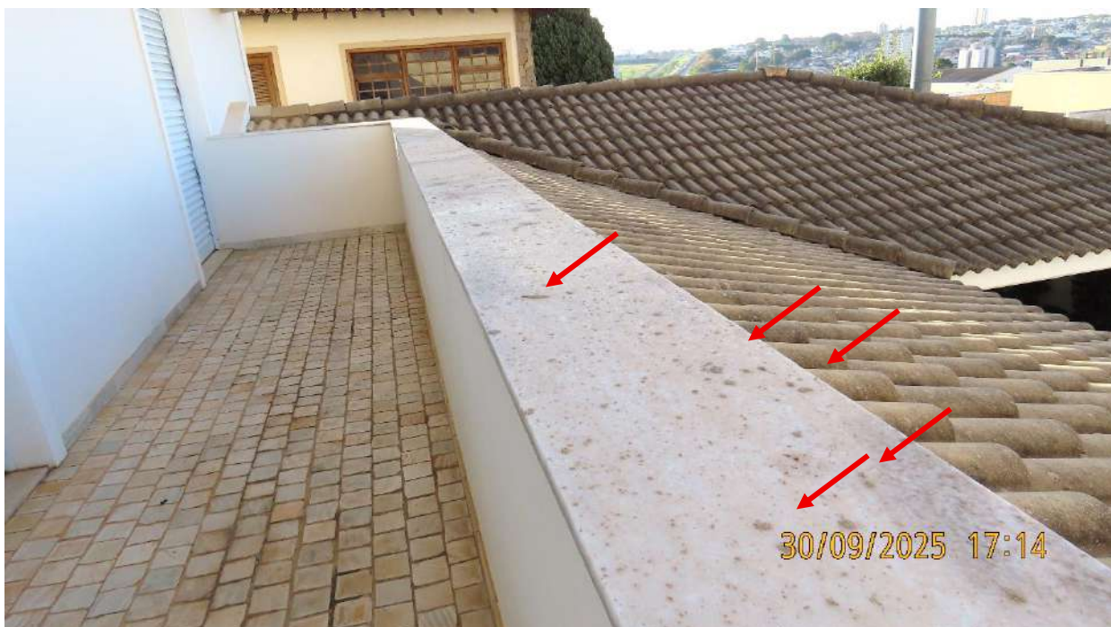
Foto 76 > Detalhe para resquícios de massa no revestimento de granito do guarda-corpo de alvenaria.
