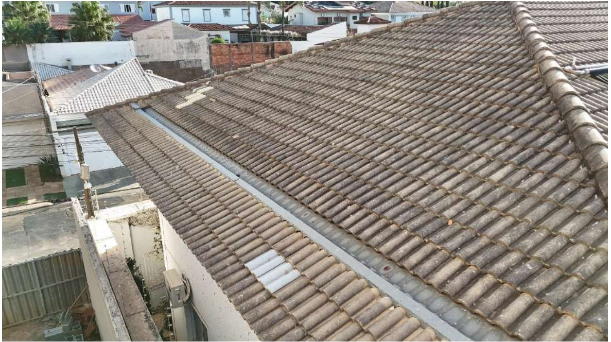
Foto 11 > Detalhe parcial da parte da casa que foi mais atingida por respingos de reboco, telhas substituídas.
