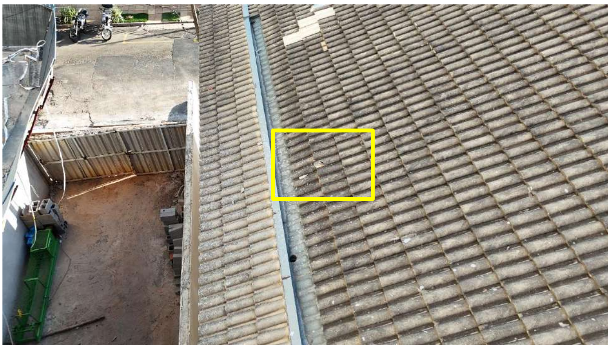
Foto 19 > Em destaque, região da cobertura próxima à obra. O quadrado indicado na figura, mostra uma telha danificada.
