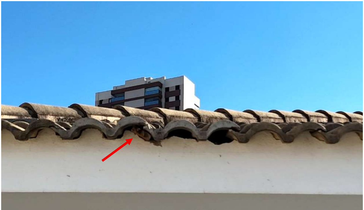
Foto 17 > Detalhe mais próximo das telhas em questão. Notar que não somente as telhas antigas foram danificadas, mas também a alvenaria que veda a cobertura. As telhas quebradas foram substituídas, mas a vedação não foi refeita.
