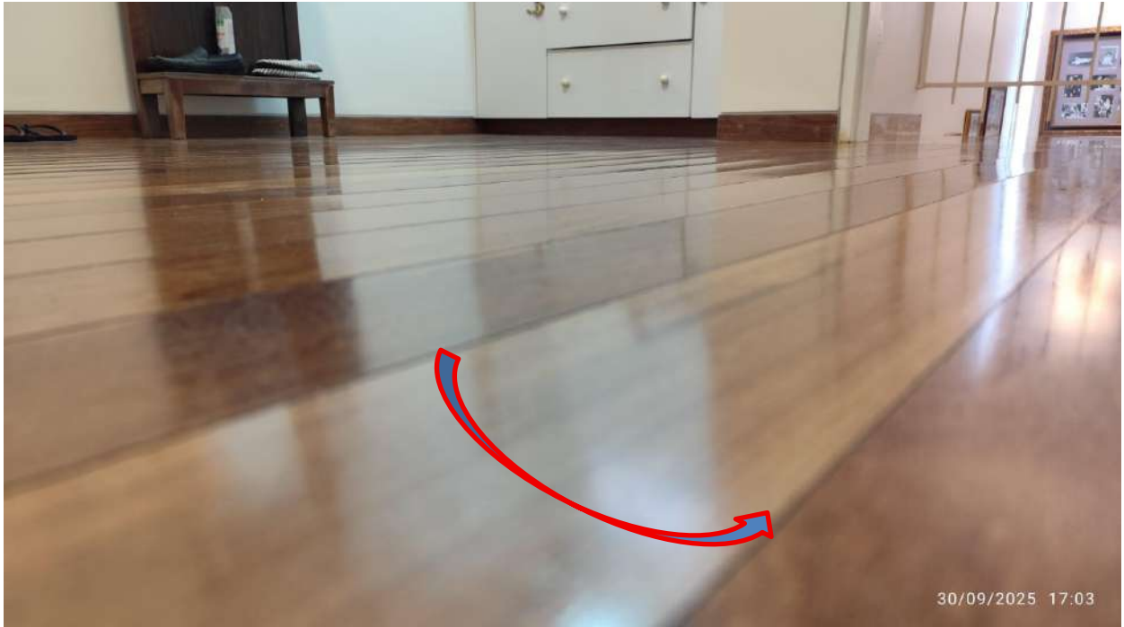
Foto 73 > Imagem próxima ao piso de madeira. Notar bordas levantadas.
