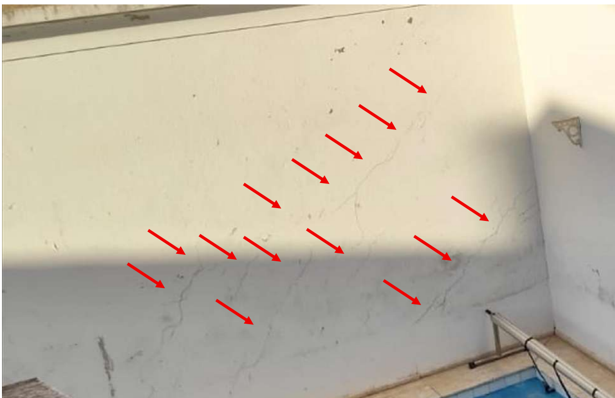
Foto 80 > Em destaque, trincas 45°. Indicam interferência da obra sobre a residência.
