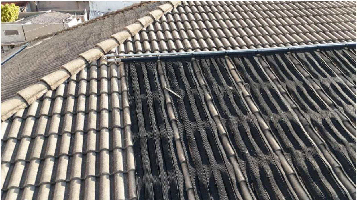
Foto 21 > Destaque para as mangueiras de aquecimento da piscina, com respingos de reboco da obra.
