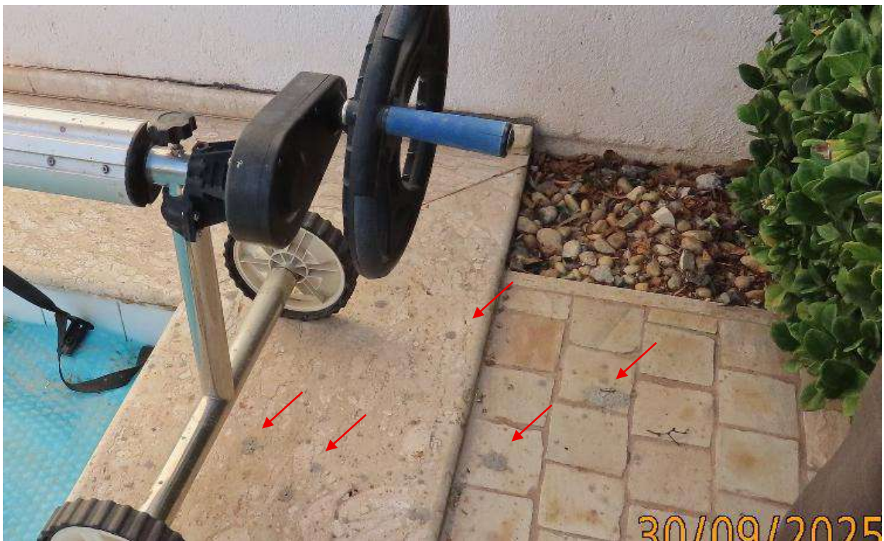
Foto 52 > Detalhe parcial para respingos de concreto destacado.
