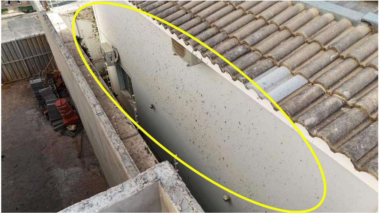
Foto 13 > Detalhe para parede atingida pelos respingos de reboco.
