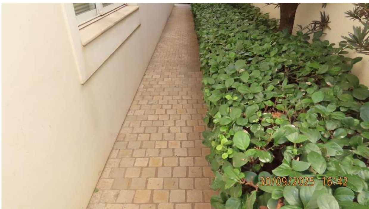
Foto 33 > Detalhe para o piso do corredor externo, próximo à obra. Este se encontra com resquícios de argamassa próximo à parede.
