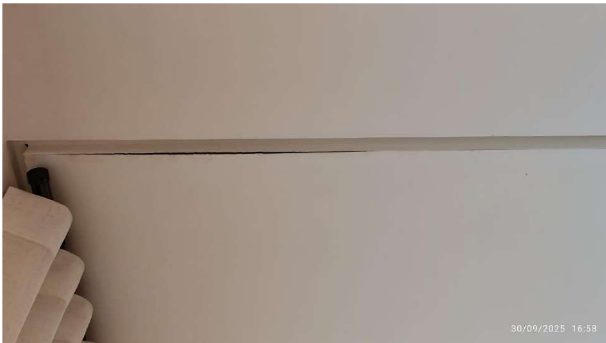
Foto 57 > Detalhe mais próximo da infiltração de água na laje/forro.
