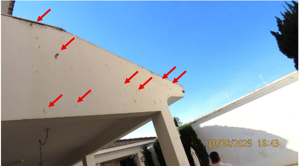
Foto 43 > Detalhe para resquílios de massa na alvenaria. Parte externa da sacada.
