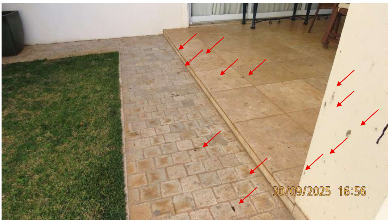
Foto 46 > Detalhe para diversos respingos de argamassa provenientes da obra.
