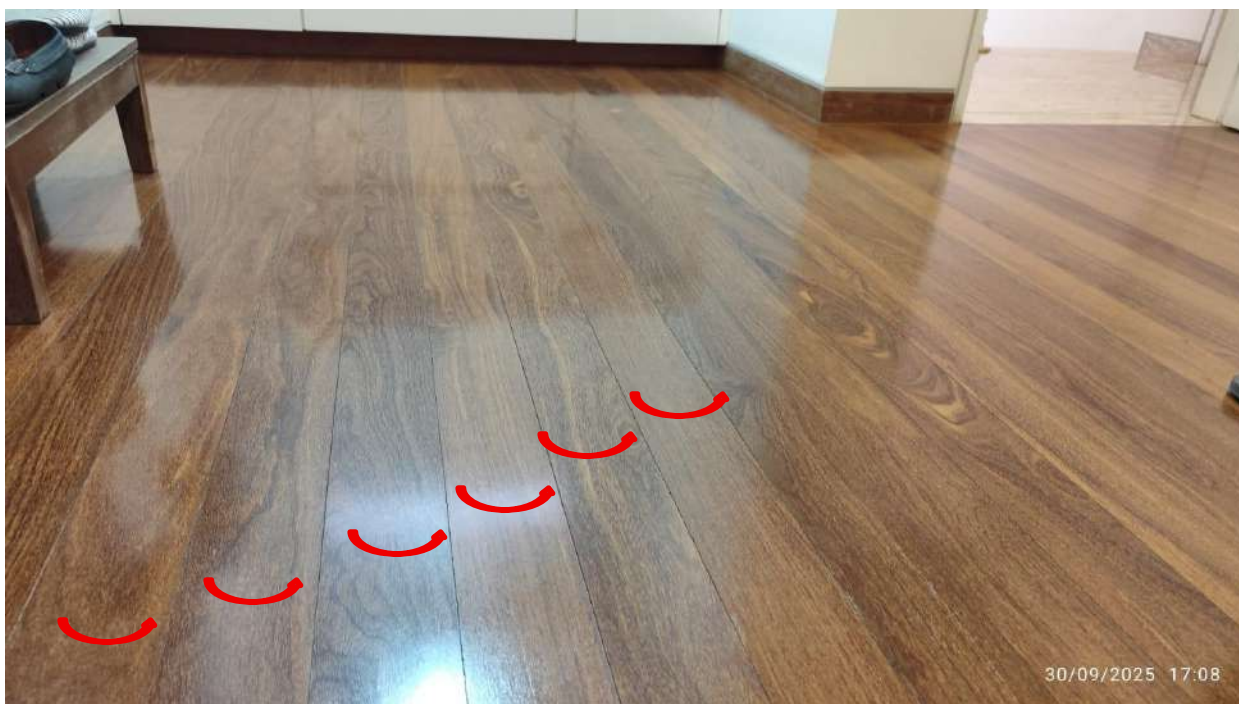
Foto 66 > O assoalho de madeira foi afetado por excesso de água, proveniente da caixa de água, que teve um encanamento rompido devido à queda de um material da obra sobre o telhado. Os detalhes destacados na imagem indicam que o empenamento que esses materiais sofreram.
