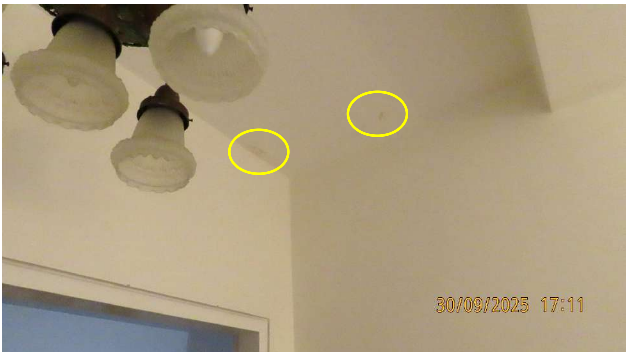
Foto 62 > Detalhe para vestígios de presença de marcas de água.
