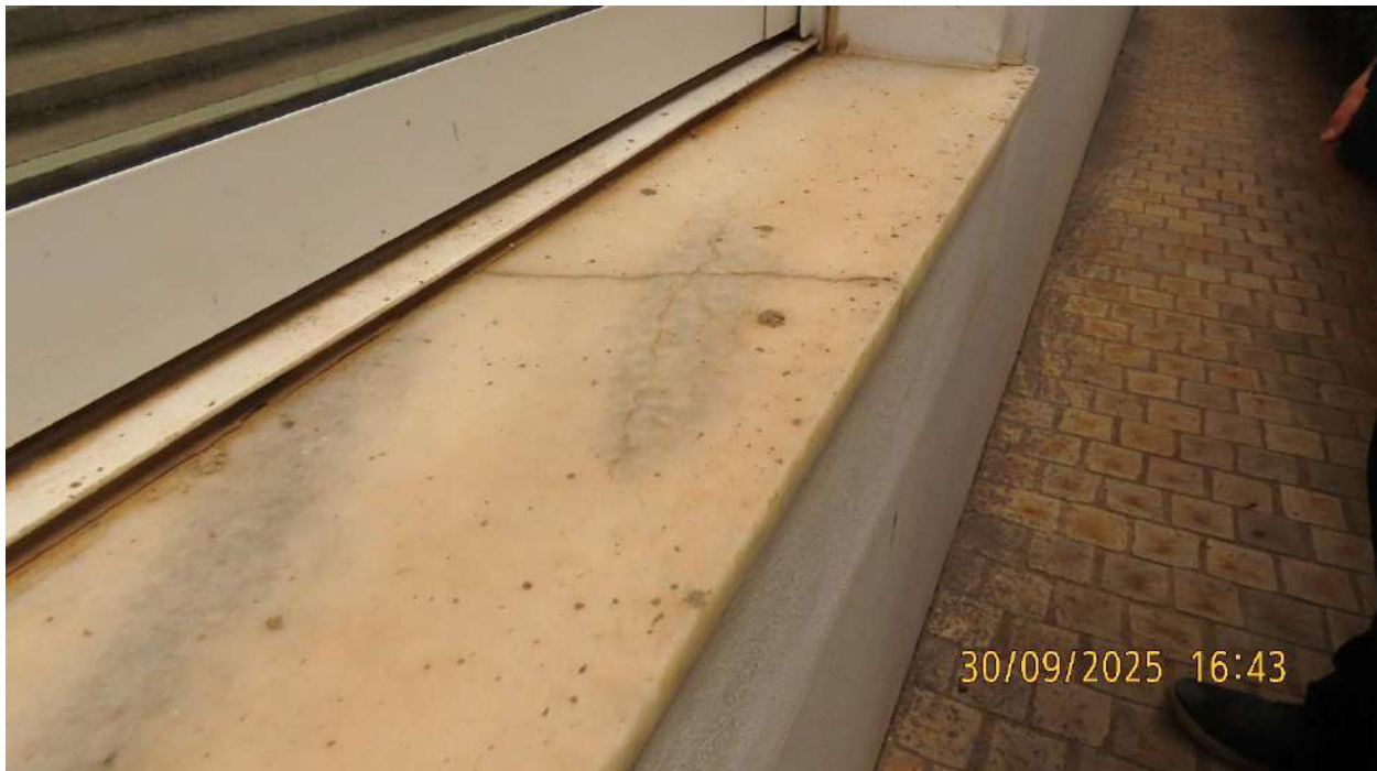
Foto 41 > Detalhe para o peitoril com respingos.
