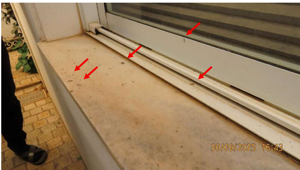
Foto 40 > Detalhe para peitoril com resquícios de argamassa.
