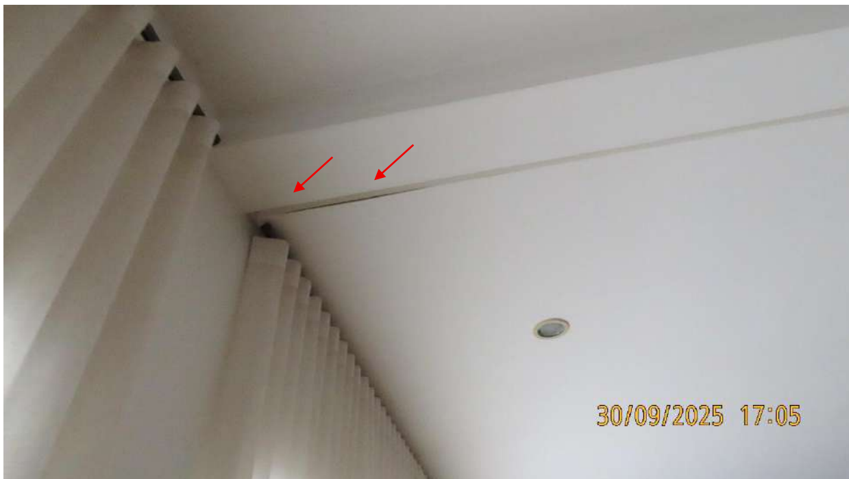
Foto 55 > Detalhe os vestígios que houve passagem de água no forro.
