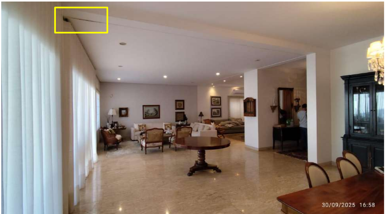
Foto 54 > Detalhe geral da sala de estar, no térreo da residência. Região destacada evidencia que o forro de gesso foi afetado por água proveniente do andar superior.
