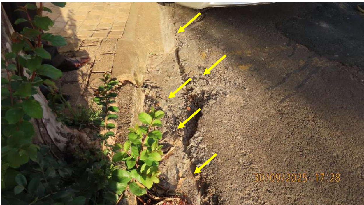
Foto 86 > Notar os resquícios de concreto na sarjeta, deixado pela obra.
