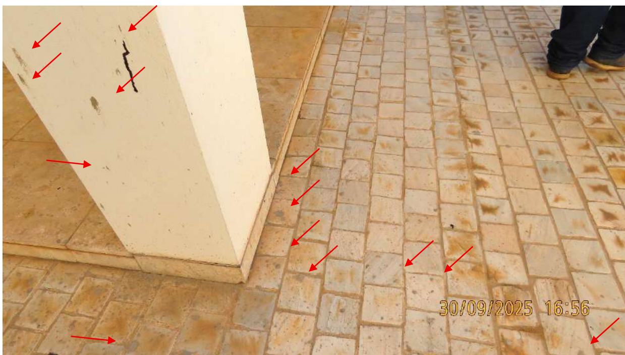
Foto 47 > Detalhe para os resquícios de reboco, da obra, que atingiu a residência em questão.
