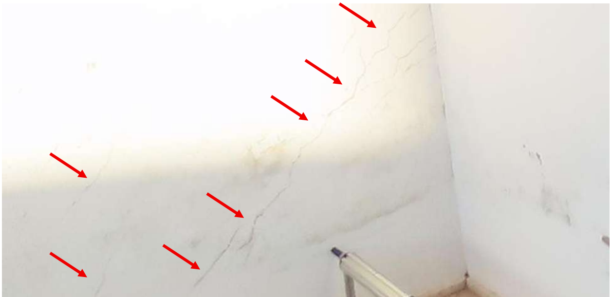
Foto 81 > Detalhe para trincas 45° na parede dos fundos da residência. Muro da direita da foto, confronta com a obra.
