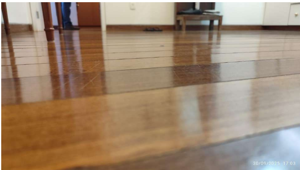
Foto 72 > A imagem do assoalho, no sentido transversal favorece a visualização do empenamento dos tacos de madeira.
