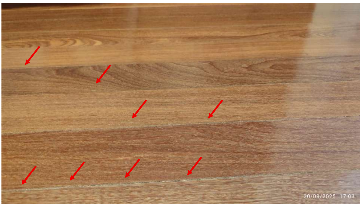
Foto 70 > Notar, as juntas afastadas devido ao levantamento das bordas dos tacos.
