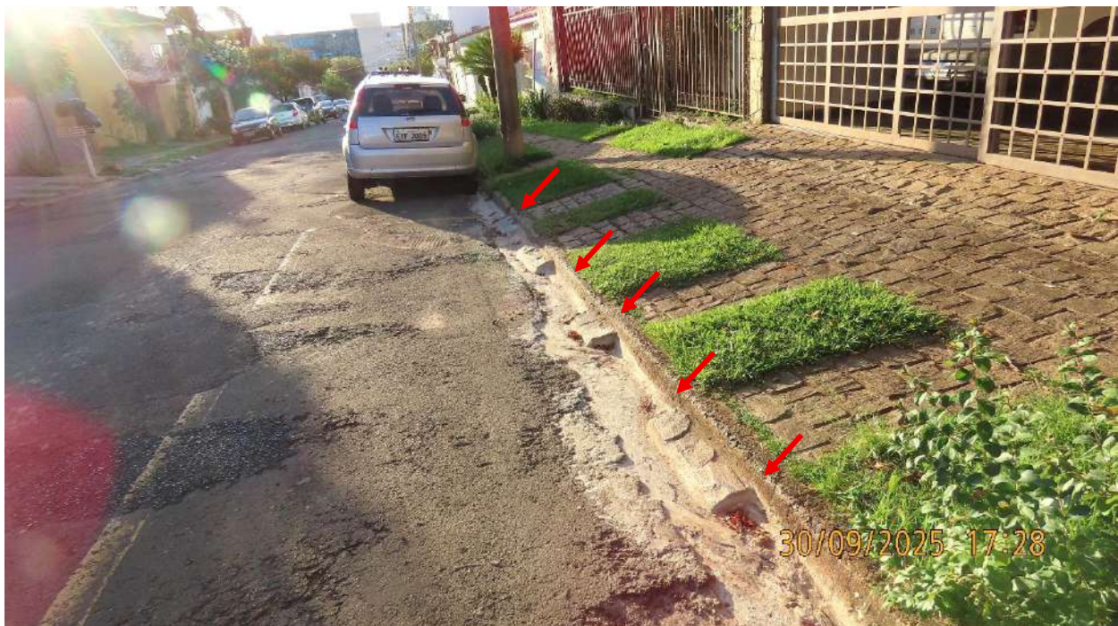
Foto 84 > Detalhe para a sarjeta com resquícios de concreto.
